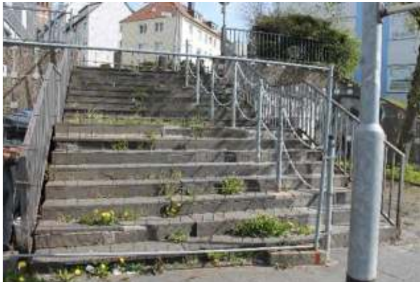
Abbildung 10: Treppenanlagen mit Mängeln in der Barrierefreiheit
